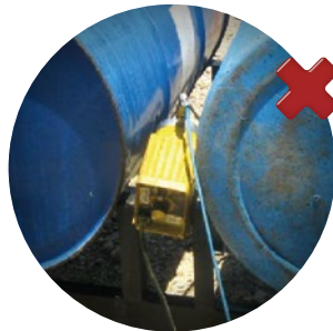
Inadecuada ubicación de la bomba dosificadora
